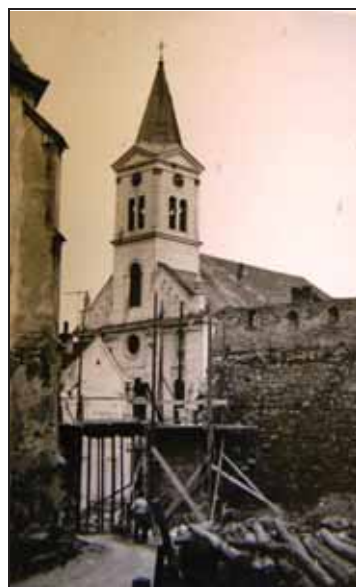
Fig. 7. Demantelarea unei porțiuni de zid pe latura de est pentru deschiderea porții (Fond DMI, dosar nr. 156)
